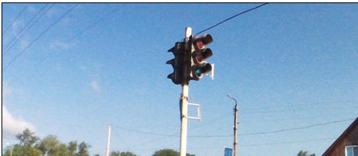
Рисунок 1.6.1 – Пример эксплуатационного состояния светофора типа Т.1 установленного по ул. Мичурина, р.п. Новоспасское
