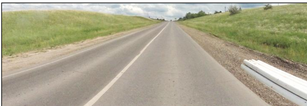
Рисунок 1.3.2 – Состояние дорожного покрытия, а/д 73 ОП РЗ К-1427 Солдатская Ташла - Кузоватово - Новоспасское - Радищево - Старая Кулатка - граница области на момент обследования
