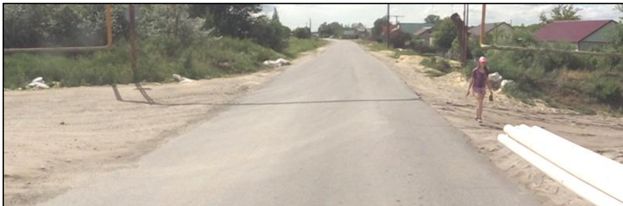
Рисунок 1.3.6 – Состояние дорожного покрытия, а/д 73 229 ОП МЗ Н-005 Новоспасское - Марьевка на момент обследования
