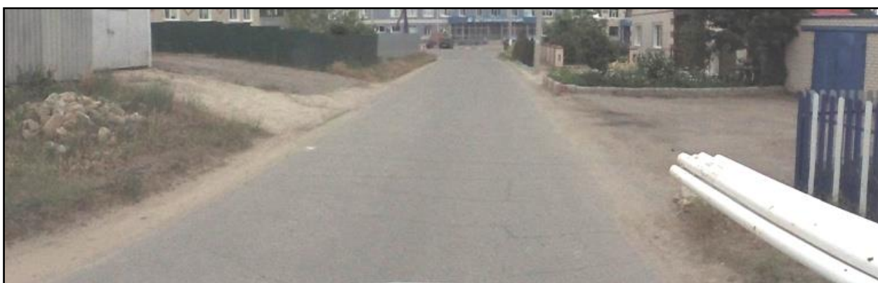
Рисунок 1.3.10 – Состояние дорожного покрытия, а/д 73-229 ОП МР 225 ул. Первомайская на момент обследования
