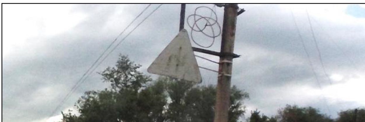
Рисунок 1.6.7 – Вид неудовлетворительного эксплуатационного состояния знака 1.12.1 «Опасные повороты», расположенного по ул. Мичурина, р.п. Новоспасское
