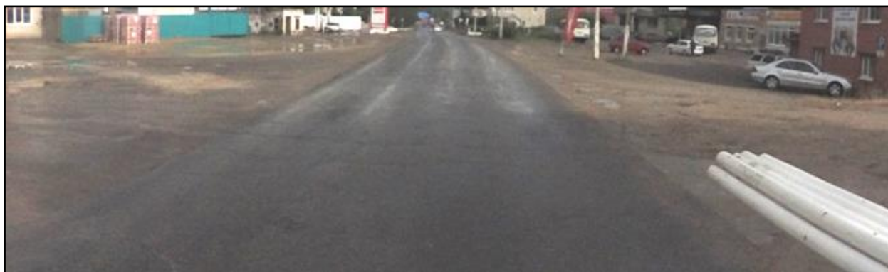
Рисунок 1.3.15 – Состояние дорожного покрытия, а/д 73-229 ОП МР 219 ул. Строителей на момент обследования
