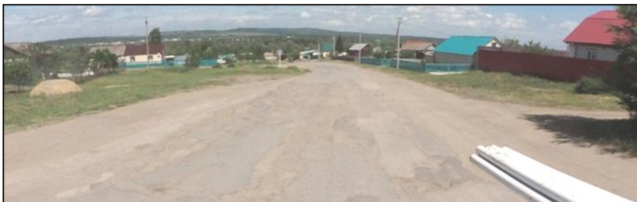
Рисунок 1.3.7 – Состояние дорожного покрытия, а/д 73-229 ОП МР 223 ул. Горшенина на момент обследования
