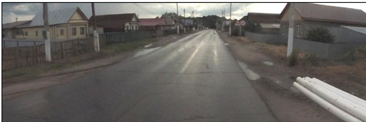
Рисунок 1.3.12 – Состояние дорожного покрытия, а/д 73-229 ОП МР 276 ул. Свердлова на момент обследования
