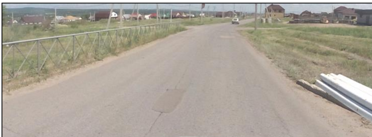
Рисунок 1.3.8 – Состояние дорожного покрытия, а/д 73-229 ОП МР 318 ул. Аэродромная на момент обследования
