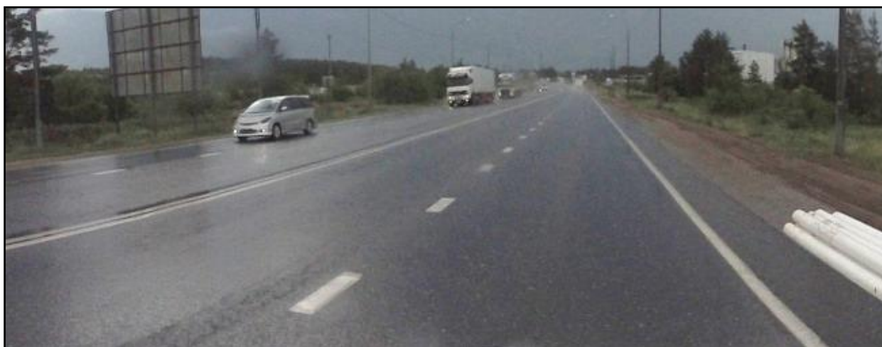
Рисунок 1.3.1 – Состояние дорожного покрытия, а/д 00 ОП ФЗ М-5 «Урал» Москва - Рязань - Пенза - Самара - Уфа - Челябинск на момент обследования
