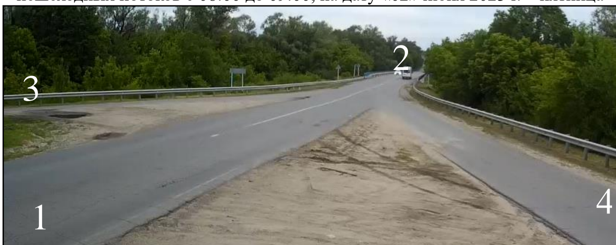
Рисунок Г.4.2 – Фото перекрестка: а/д 73 ОП РЗ К-1427 Солдатская Ташла - Кузоватово - Новоспасское - Радищево - Старая Кулатка - граница области – съезд с моста – въезд на мост (развязка)
